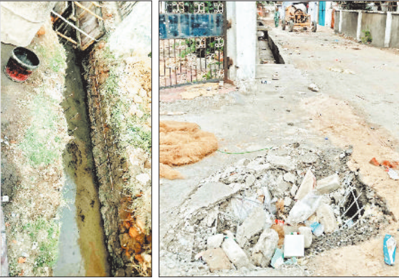
गुणवत्ताहीन नाली निर्माण।
